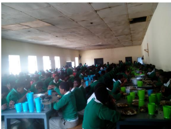
Plafond eetzaal heeft nood aan herstelling
